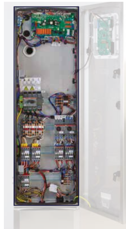
Ein Anschluss nötig für die gesamte Anlage
